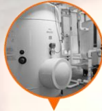
Sistema de Agua Caliente Sanitaria (ACS)
